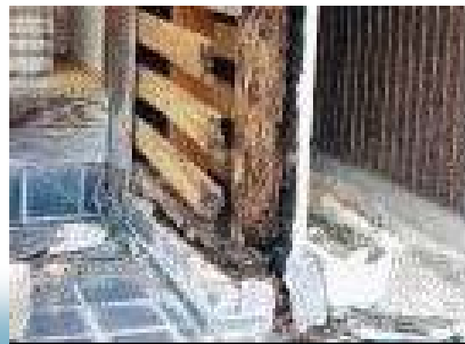
雨漏りによる腐朽被害
