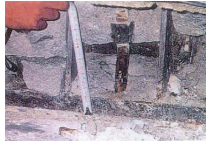
アンカーボルトの抜け出し
