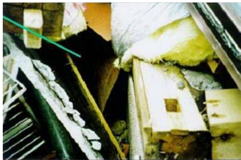
隅柱の引き抜け(金物なし)
