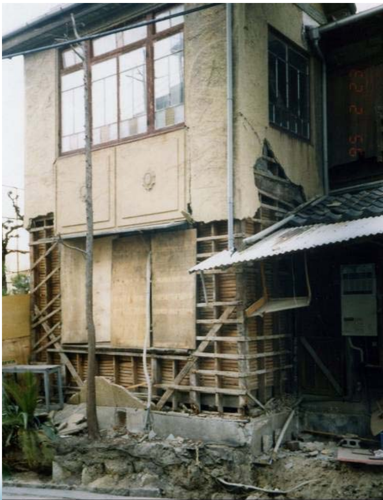
腐朽による柱の被害
