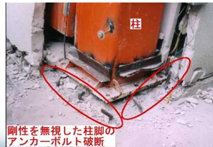
アンカーボルトの破断
