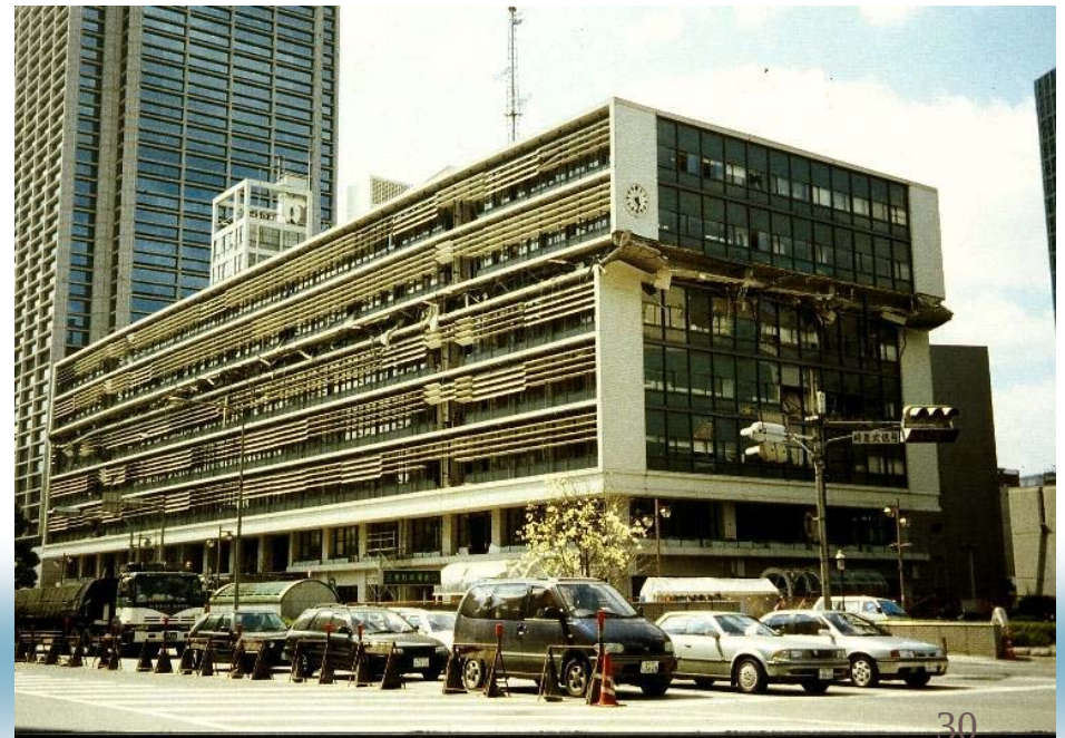
中間層の被害
