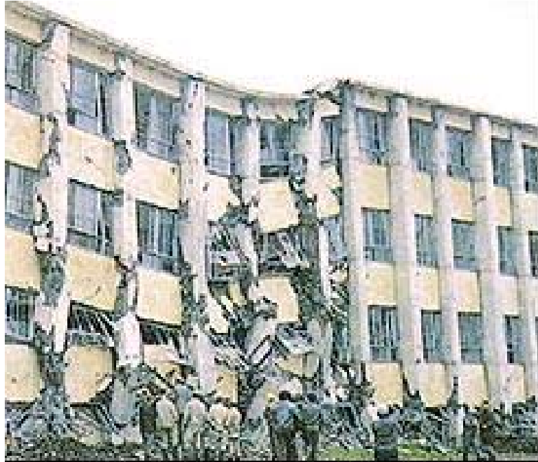
1968年十勝沖地震 (RC造短柱被害)
