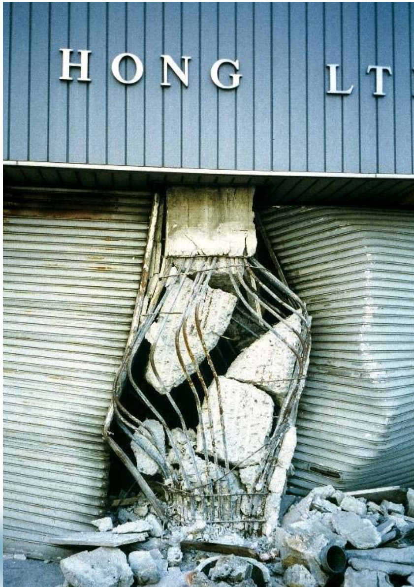
1971年の耐震基準より古いRC建物の柱被害
