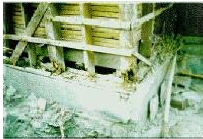
腐朽による柱の被害
