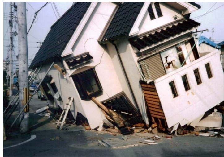
1階の耐震要素が偏心して倒壊した建物
