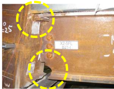
梁端フランジの破断
