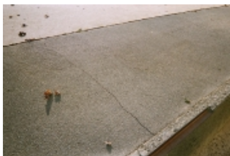
写真 17 クラックの入ったコンクリート
