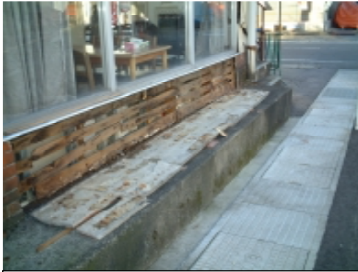
写真 30 土台への損傷を受けた商店 2
