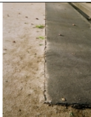
写真 15 体育館とテニスコートの境界 今回の地震によりズレたと思われる。
