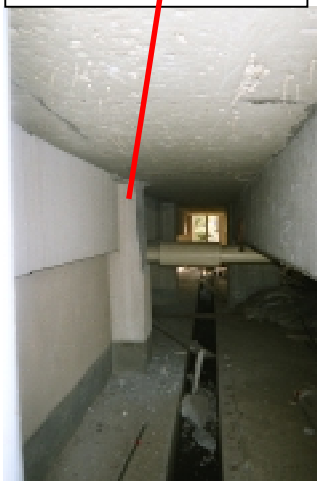
写真 21 2 棟の連結部分の損傷
