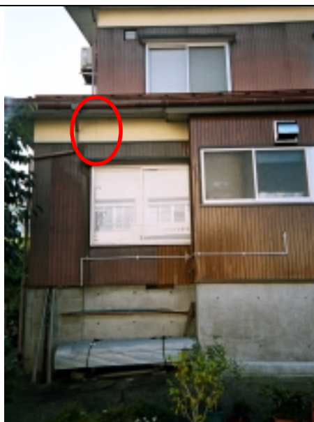
写真5 周辺住宅 僅かなクラックが見られた。
