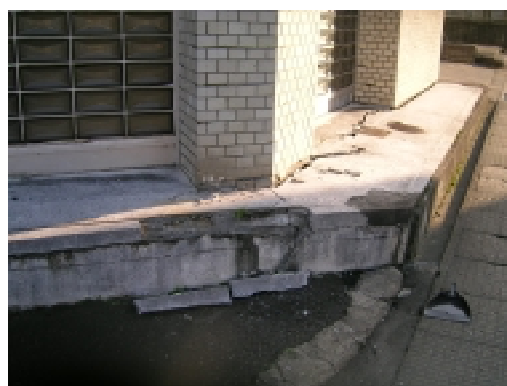
写真 29 土台への損傷を受けた商店
