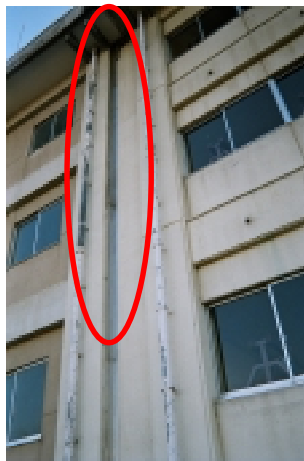
写真 19 2 棟の連結部分の損傷
