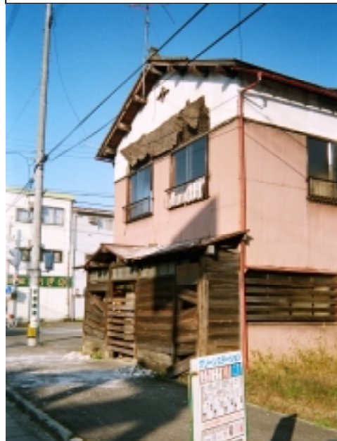
写真 27 漆喰と思われる外壁の剥落
