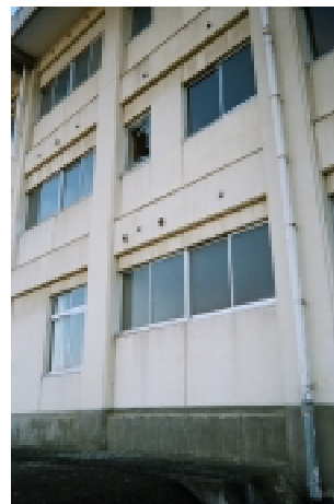
写真 20 窓ガラスの割れ
