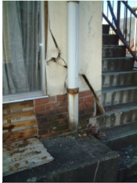
写真 31 外壁への損傷を受けた商店
