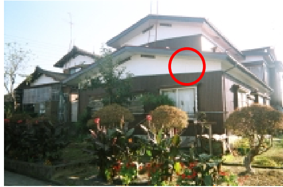
写真8 漆喰と思われる部分に僅かなクラックが見られた。
