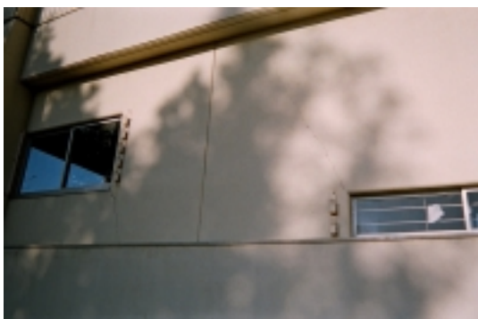
写真 16 クラックの入った体育館の外壁
