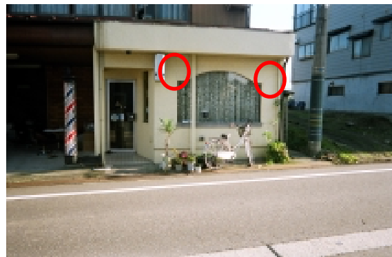
写真10 外壁にクラックの入った理髪店
