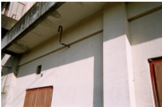
写真 12 壁にクラックの入った倉庫らしき建物
