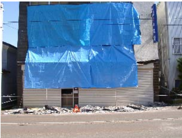
写真-6 商店の外壁剥落(与板町上町、このあたりから町が停電)
