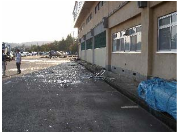
写真-32 市民体育館のガラスの割れ(小千谷市土川)
