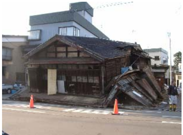
写真-26 1階が倒壊した木造住宅(小千谷市本町)
