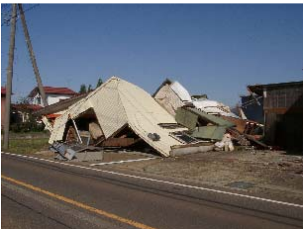
写真-7 崩壊した民家の車庫(小千谷市小栗田)
