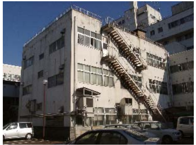
写真-9 小千谷総合病院の北西側張り出し部分(1Fの柱がせん断破壊し、軸耐力を失っている。ここは資料室らしく、全体の建物は3F以下は通常に機能していた。柱の詳細は次の写真)
