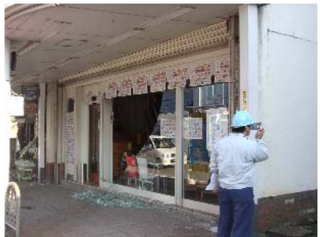
写真-21 291 号の商店街の店舗のガラスの割れ
