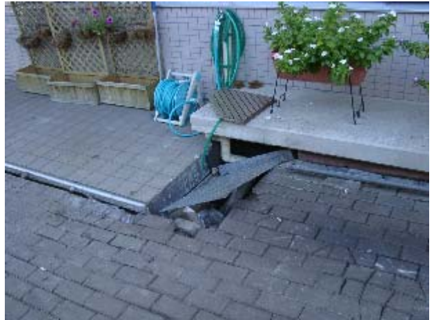
写真-13 免震建物の外構の損傷
