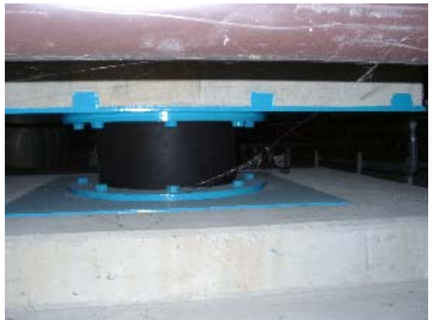
写真-14 積層ゴムの残留変形(暗くてよくわからないが変形が認められる。)
