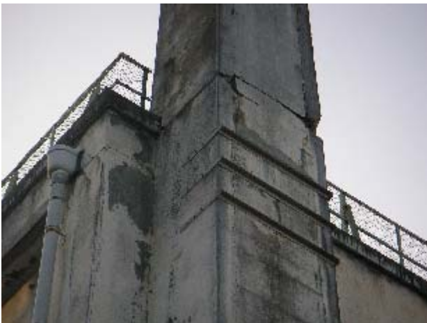
写真-30 小千谷小学校の煙突のひび割れ(曲げひび割れが全面に広がって危険)
