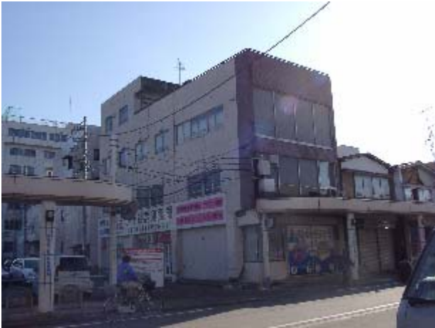
写真-16 291 号の商店街の 3F の RC 造被害建物の全景（道路に沿った方向（東西方向）の被害が大きい。一番手前の柱の詳細は次写真）
