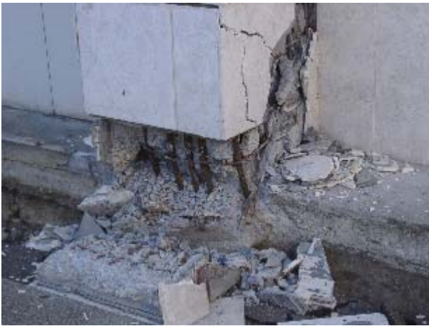
写真-17 柱脚の破壊状況（東西方向の柱脚ヒンジ領域の（曲げ破壊後の？）せん断破壊、主筋の座屈が見られる。52×58cm角（仕上げ無し）、主筋 29、帯筋 9@約150（90度フック）
