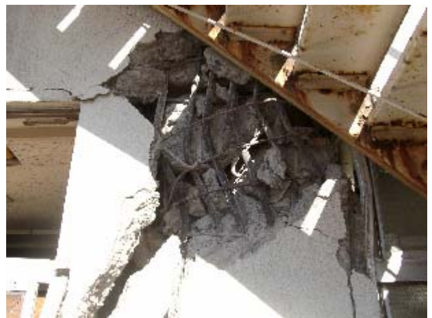
写真-10 1階柱のせん断破壊後の圧縮破壊(幅仕上げ含み600mm、主筋29、帯筋9@約150(90度フック))
