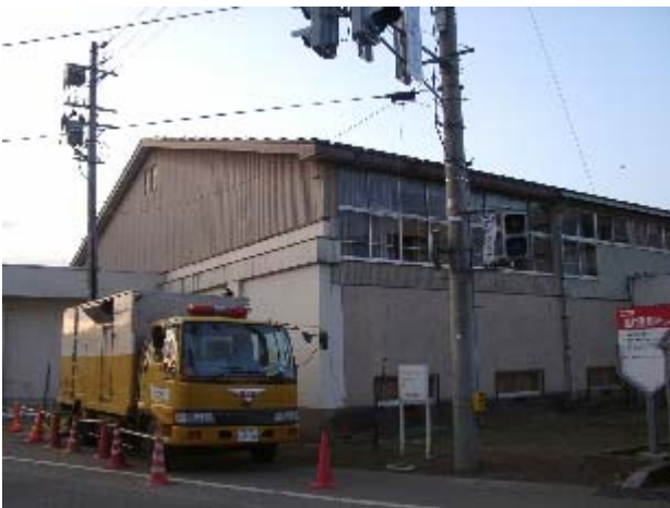
写真-35 千田中学校の体育館の様子 隅柱に縦にひび割れがあったが、その他大きな被害なし(ひび割れは次の写真)
