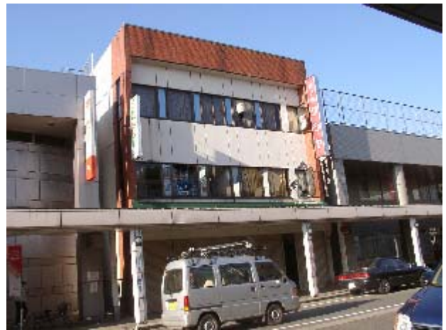
写真-20 291 号の商店街の店舗の外壁損傷状況(2, 3F がプレキャストのコンクリートのようなところが一部コンクリートが剥落)
