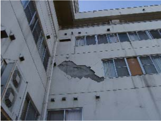
写真-11 南側 3F 袖壁に生じたせん断破壊(小千谷総合病院)
