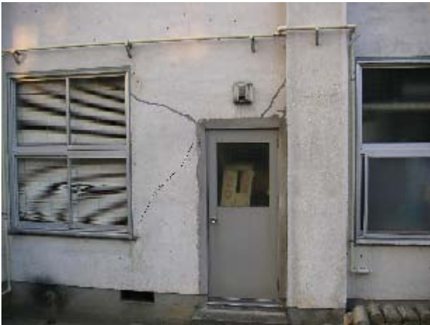
写真-29 小千谷小学校の外壁のせん断破壊
