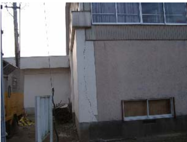
写真-36 千田中学校体育館の柱に入ったひび割れ
