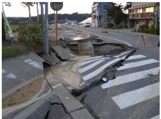
写真-38 千田小学校前の陥没した道路
