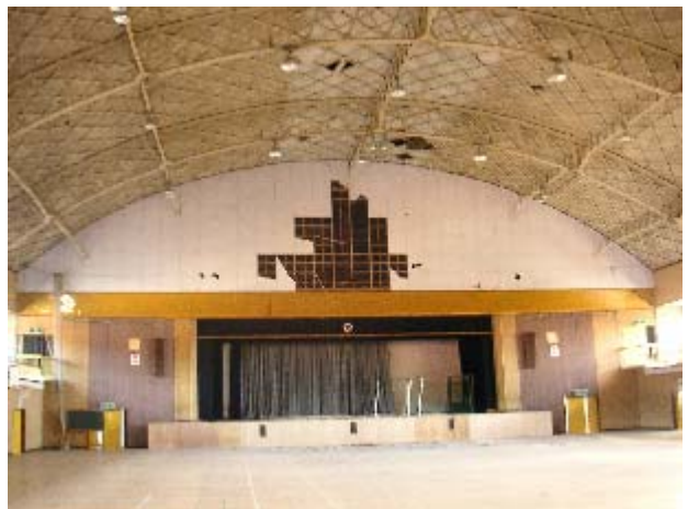
写真-33 体育館内の様子(RS系のSK式シャーレン?、剛床ありそうだが、ガラスが割れ、内装も剥落あり、避難所として使われていなかった)
