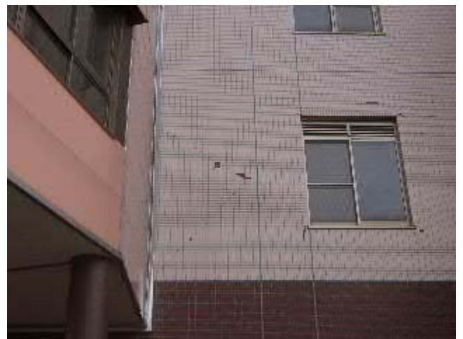
写真12 1F壁のせん断破壊
