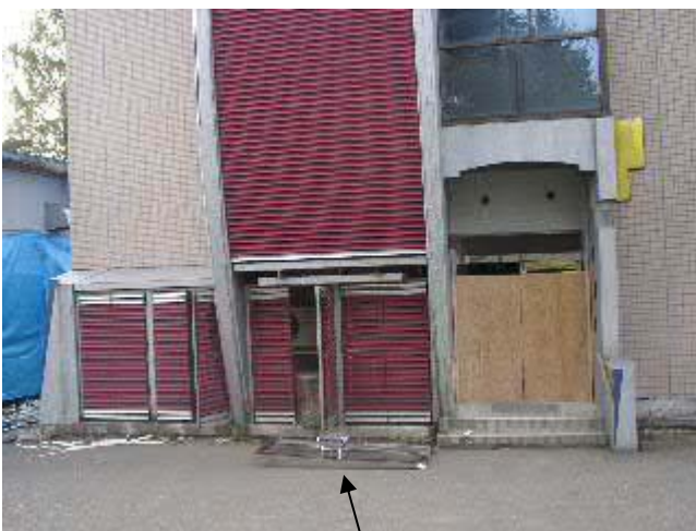
写真21 5号館の南のドアがはずれていた
