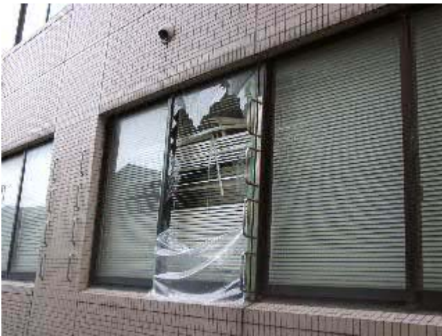
写真20 5号館の東側のガラスの割れ（多数有り）
