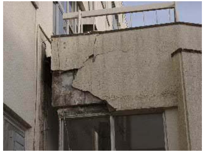
写真10 3号館と2号館の渡り廊下、取り付け部の損傷
