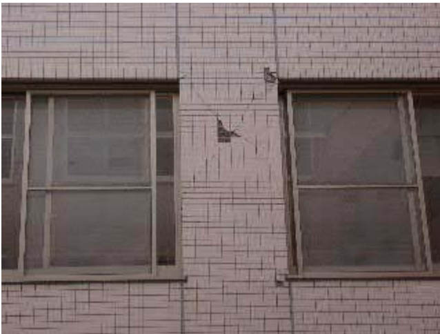
写真13 2F柱のせん断破壊
