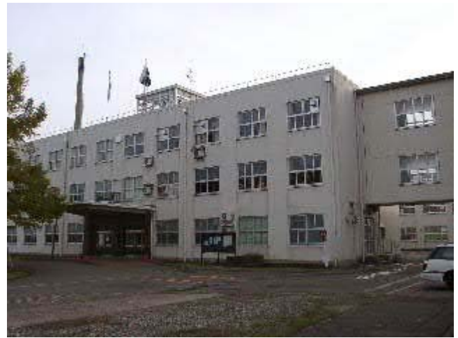
写真22 1号館（軽微なひび割れ有り）
