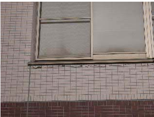
写真14 よくみられたタイルの損傷1
