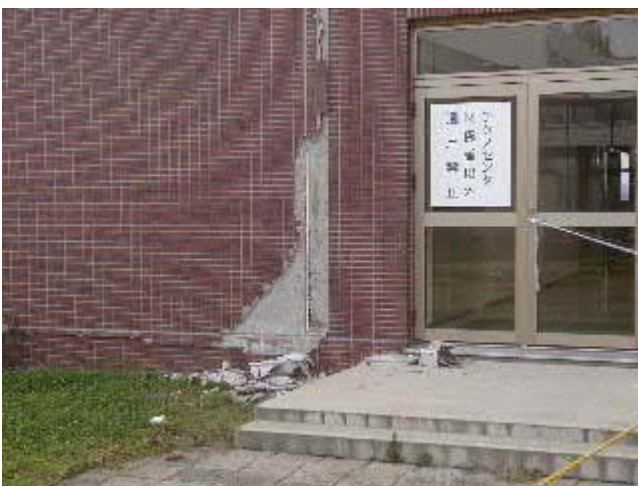
写真15 よくみられたタイルの損傷2
