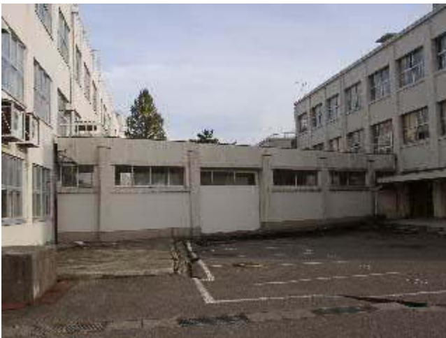
写真9 3号館（右）と2号館の渡り廊下、取り付け部は損傷している
