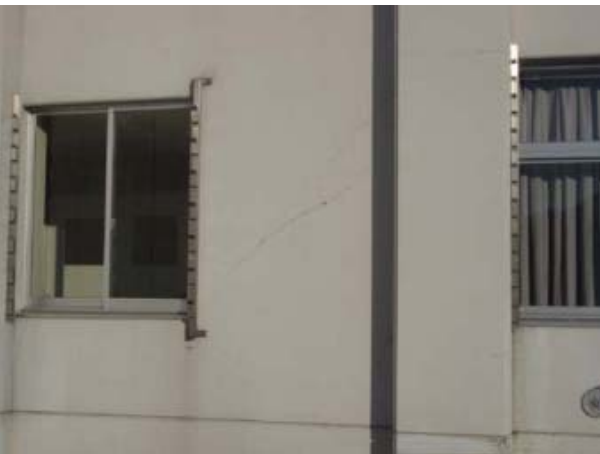
校舎1階のせん断ひび割れ
