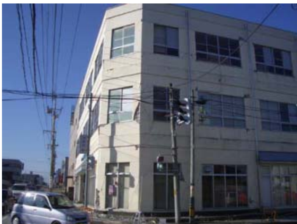
鉄骨造 3 階建て外壁の損傷
