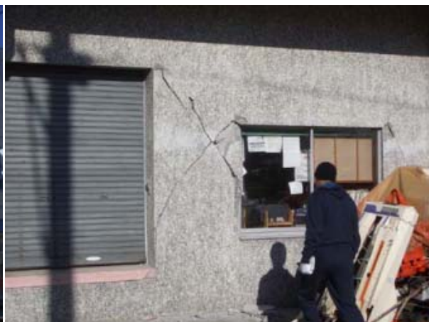
鉄骨造 3 階建て 1 階外壁の損傷（左とは別）
