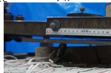
(c) アンカーボルト破断
