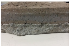
b) 剥離剥落物
