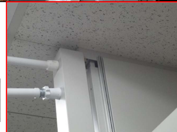
間仕切り材の破損 (揺れている最中、学生 さんが押さえていました)
