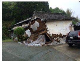
写真2 倒壊した土蔵
