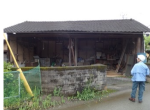
写真4 倒壊を免れた納屋
