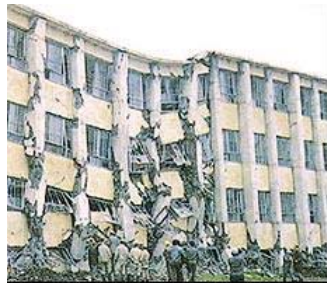
1968年十勝沖地震 (RC造短柱被害など)
