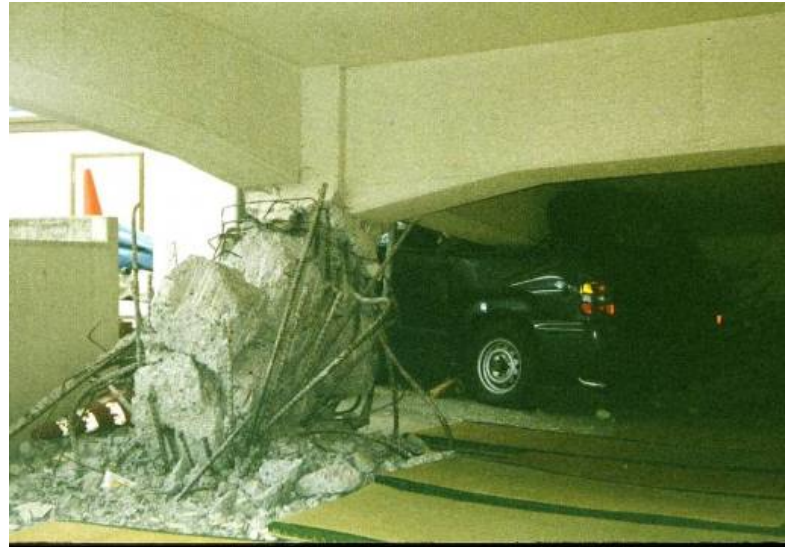
図7 旧基準の RC 造建物のピロティー層の被害
