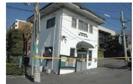
液状化(浦安市)
