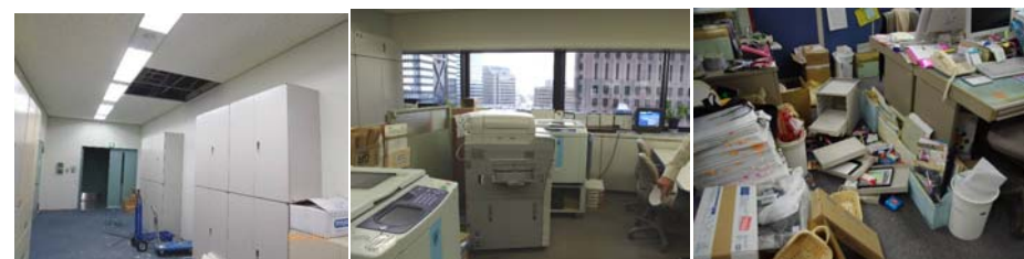
14F (天井パネルの落下)
