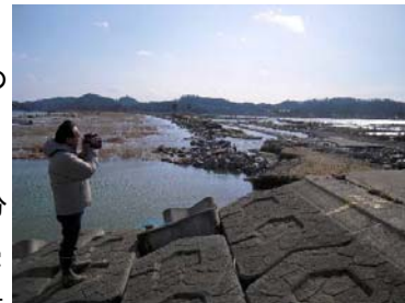
破壊された防潮堤(宮城県東松島市)
