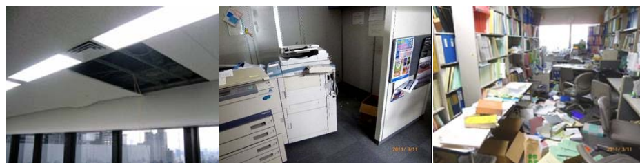
28F (天井パネルの落下)
