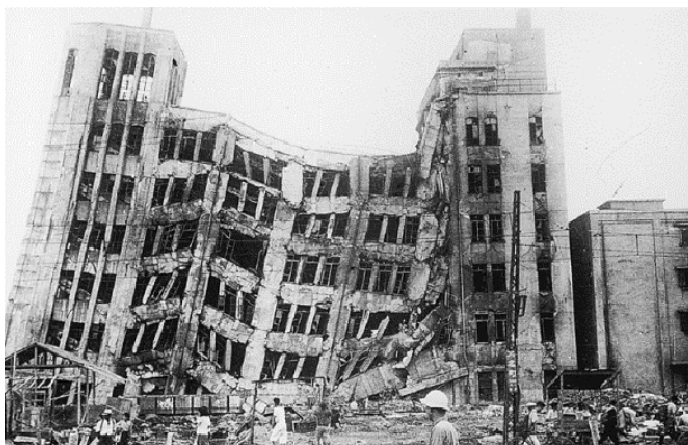
損壊した大和百貨店（福岡市）。1 階が潰れ、各階の梁が著しく破壊し、また火災による被害も受けた。小林啓美氏（東京工業大学名誉教授）撮影・提供。
