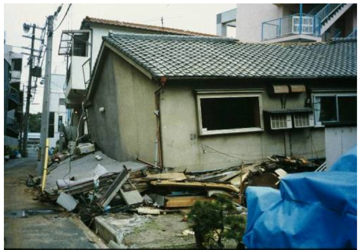
図5 1階の壁不足による木造家屋の被害
