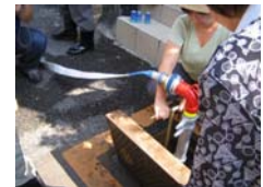
消火栓とスタンドパイプ
