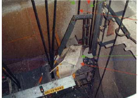
非常用エレベータメインロープ の着床板裏への絡まり、変形破損
