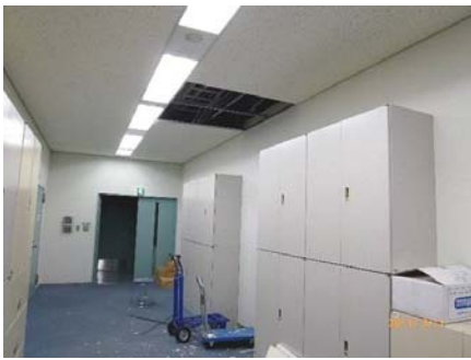
14F (天井パネルの落下)
