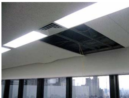
28F (天井パネルの落下)
