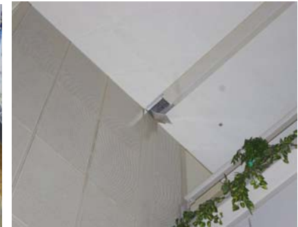
1F (アトリウム:EPJパネルの被害)
