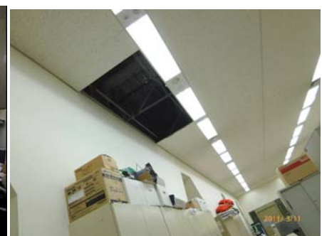
21F (天井パネルの落下)
