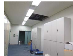
14F (天井パネルの落下)
