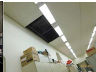
21F (天井パネルの落下)
