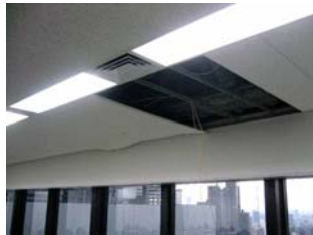
28F (天井パネルの落下)
