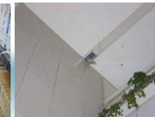
1F (アトリウム: EPJパネルの被害)
