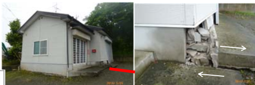
①古い在来木造(RCブロック基礎)、D4(大破)
