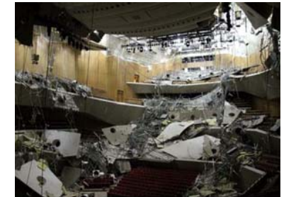
天井落下(川崎市音楽ホール)
