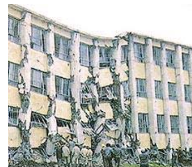
1968年十勝沖地震 (RC造短柱被害)
