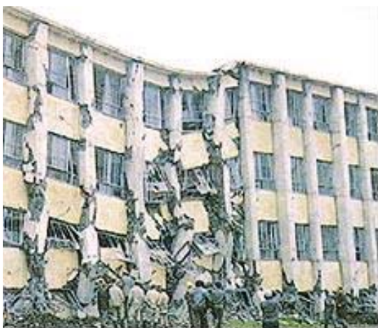
1968年十勝沖地震 (RC造短柱被害)
