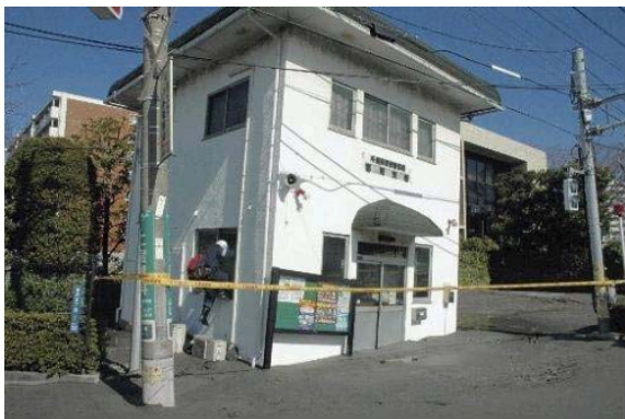
液状化(浦安市)
