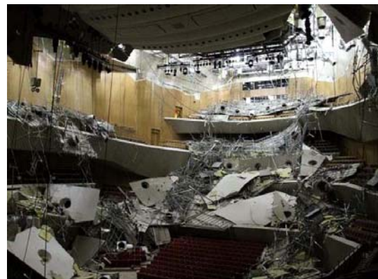
天井落下(川崎市音楽ホール)
