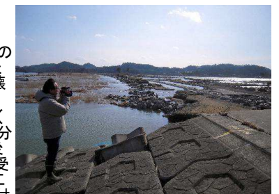
破壊された防潮堤 (宮城県東松島市)
