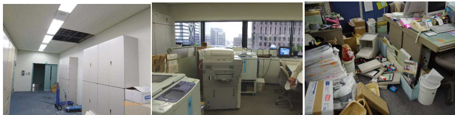
14F (天井パネルの落下)
