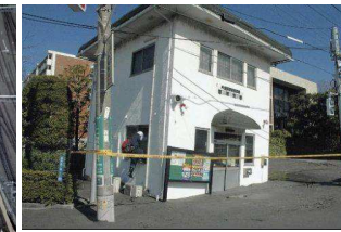
液状化被害(浦安市)
