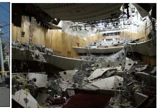
天井落下(川崎市音楽ホール)
