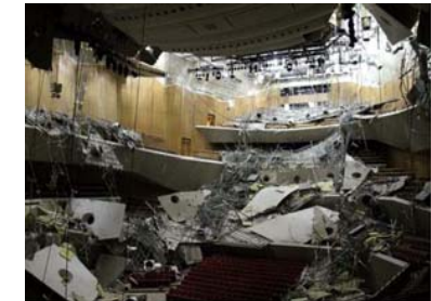
天井落下（川崎市音楽ホール）
