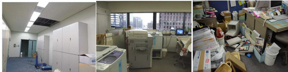
14F (天井パネルの落下)
