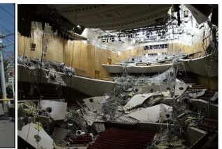
天井落下(川崎市音楽ホール)
