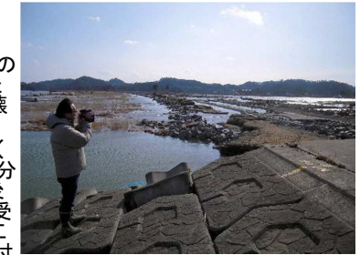
破壊された防潮堤(宮城県東松島市)
