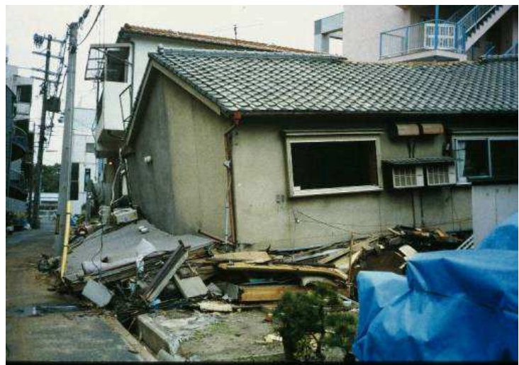
図5 1階の壁不足による木造家屋の被害
