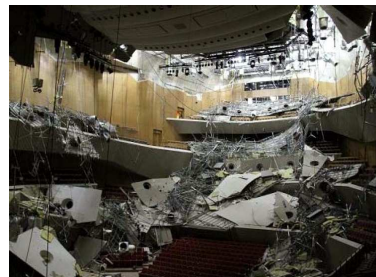
天井落下(川崎市音楽ホール)
