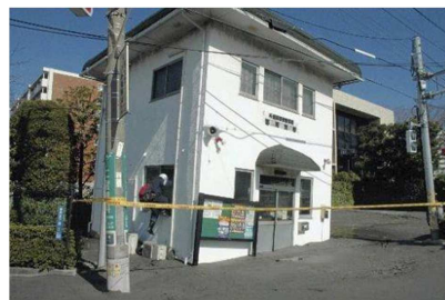
液状化(浦安市)
