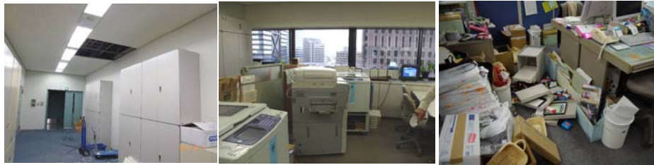
14F (天井パネルの落下)
