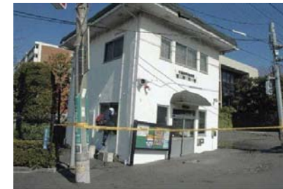
液状化(浦安市)
