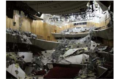
天井落下(川崎市音楽ホール)
