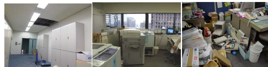
14F (天井パネルの落下)
