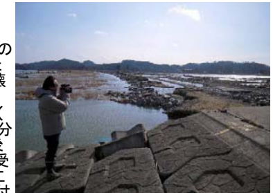
破壊された防潮堤(宮城県東松島市)
