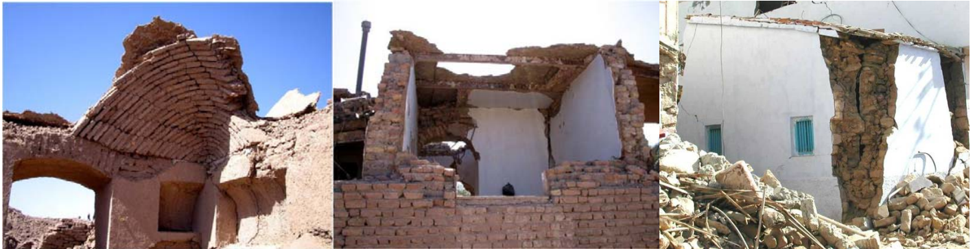
(a) アドベの地震被害(イラン・バム市)
