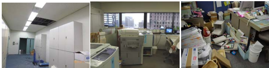
14F(天井パネルの落下)
