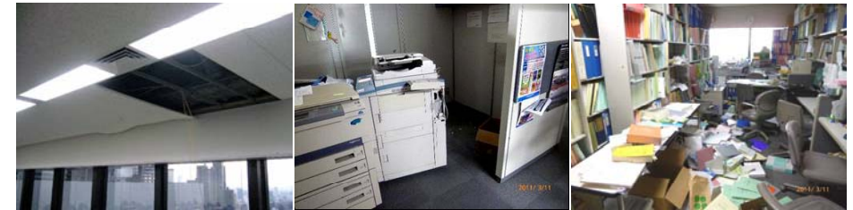
28F(天井パネルの落下)
