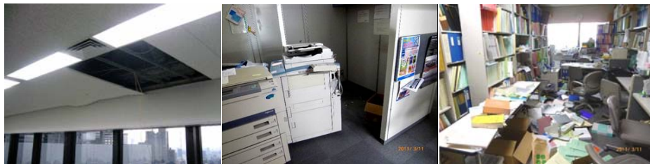
28F (天井パネルの落下)
