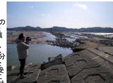
破壊された防潮堤(宮城県東松島市)
