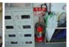
(c) 消火器の設置場所
