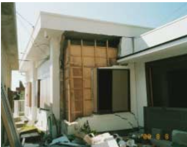
図 30：新島若郷地区の住宅の被害（中破）（表 6 記号 22 の住宅）
