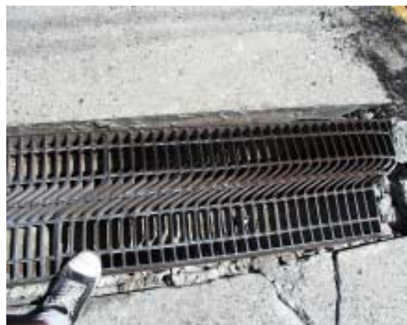
図28：若郷地区の道路を横切る排水溝のグレーチングの変形
