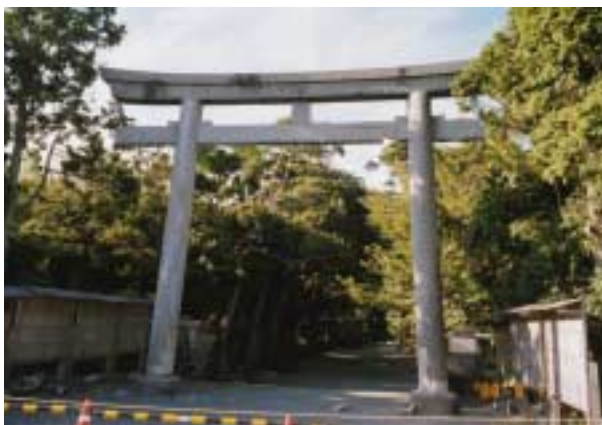
図 22：十三社神社の破損した鉄筋コンクリートの鳥居
