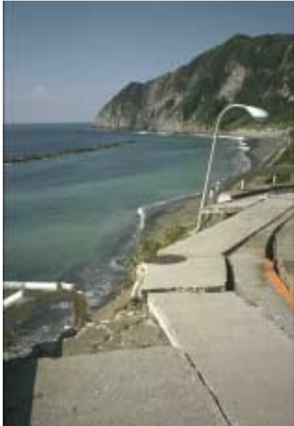
図 13：若郷地区へ通じる道路沿いの崖崩れによる路肩損傷
