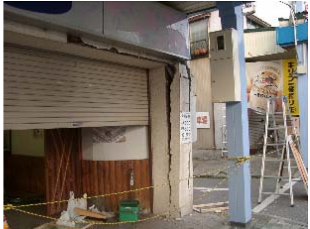
写真-30 仕上げモルタルの剥離
