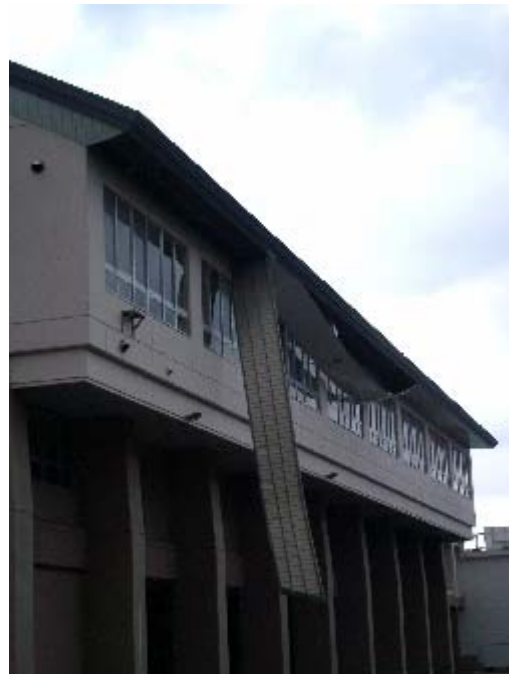
写真-36 軒裏仕上げ材が剥離し垂れ下がる。
