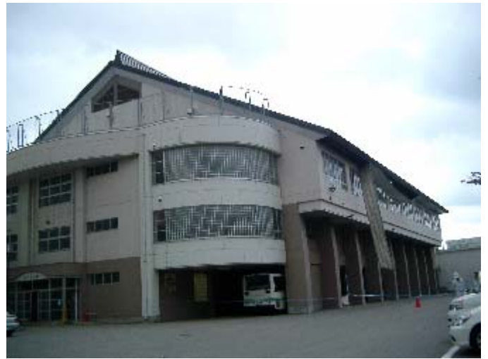
写真-35 川西中学校体育館 軒裏仕上げ材, 雪囲い受けに被害(詳細は次の写真)
