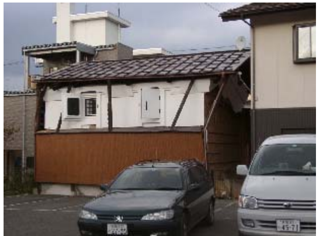
写真-31 土蔵の被害状況(十日町市高田)、土壁の剥がれおよび壁の傾き
