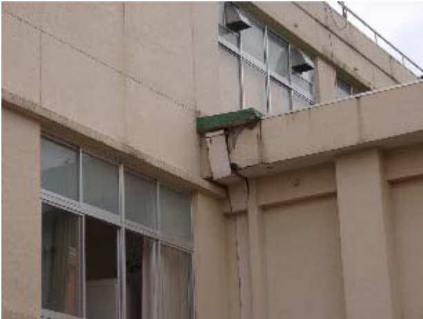
写真-9 エキスパンションジョイントの被害
