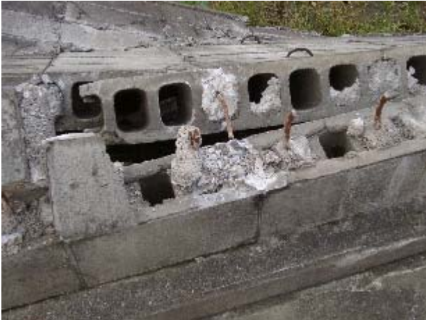
写真-27 塀の縦筋の配筋状況、定着長の不足及び縦筋の継手の不良
