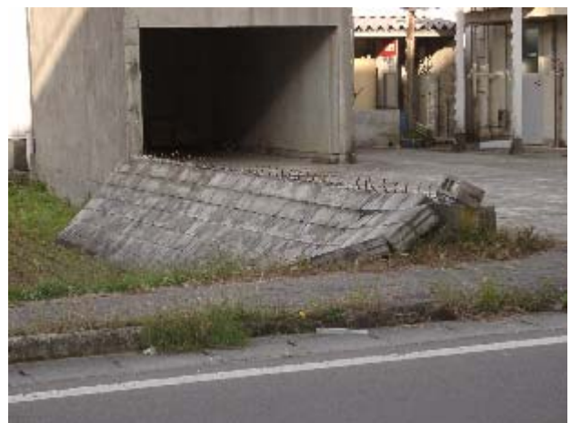
写真-26 コンクリートブロック塀の転倒(十日町)
