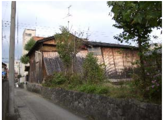
写真-32 傾斜した住宅(十日町市高田)、大破 周辺道路へは立入り禁止
