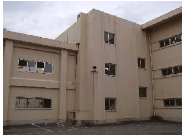
写真-8 通路取付け部の破壊
