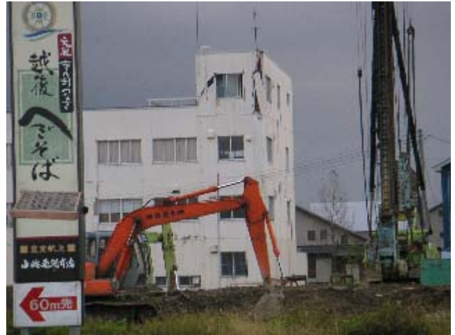
写真-39 外壁ALC版の脱落
