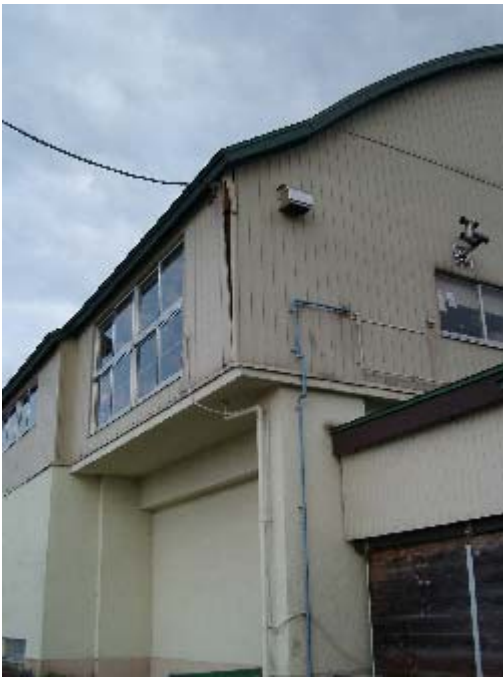
写真-21 外壁の浮き上がり
