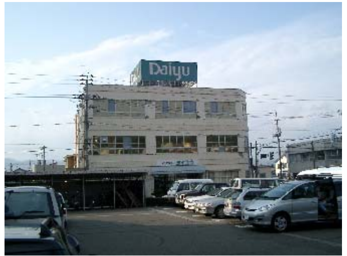
写真-24 鉄骨造店舗ビル外観(十日町市寿町)外壁に被害(詳細は次の写真)
