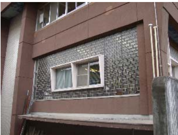
写真-23 ガラスブロック壁の損傷
