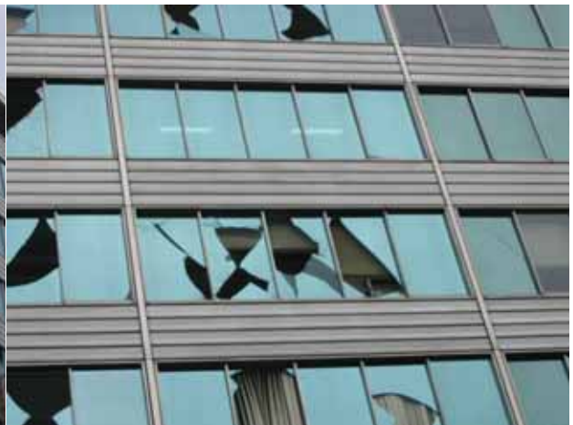
1 ガラス破損・落下
