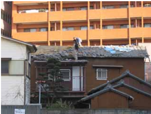
1 0 木造住宅の屋根損傷
