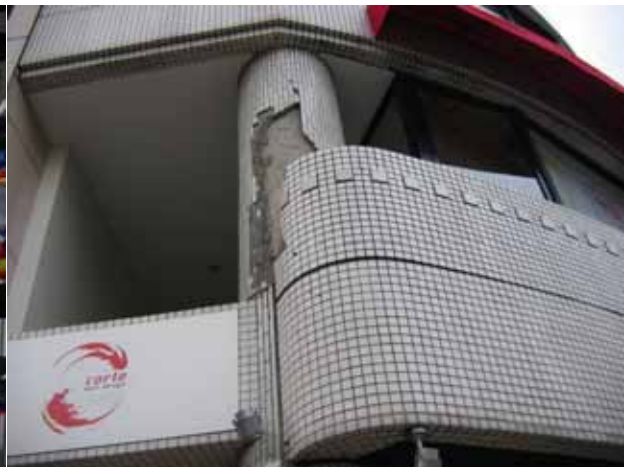
4 外壁破損・落下
