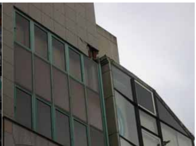
5 鉄骨造建物 外壁剥落
