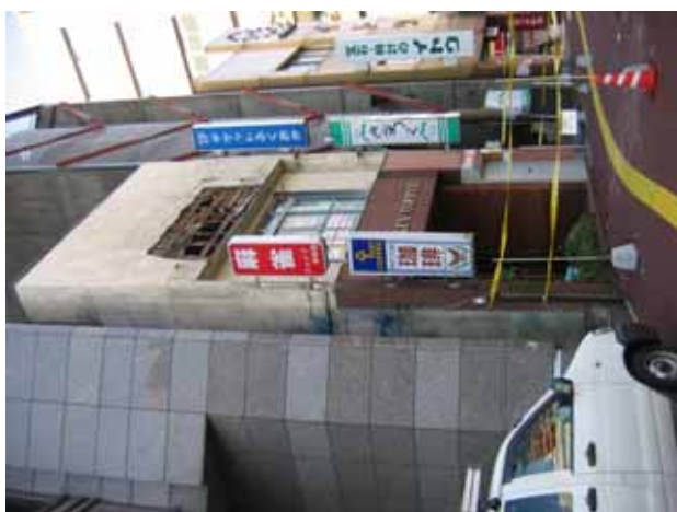
6 木造建物 外壁落下
