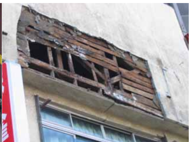
6 木造建物 外壁落下
