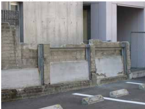
D 補強した塀 補強より上部が落下
