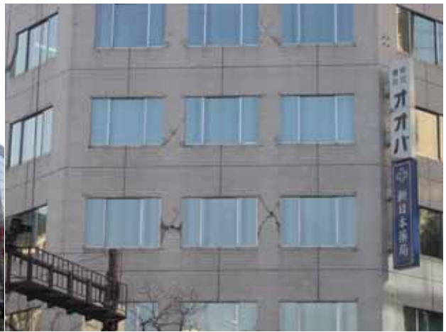
7 外壁破損（方立て壁？）
