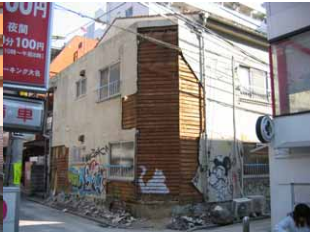
1 1 木造住宅外壁破損・落下
