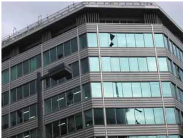
1 ガラス破損・落下
