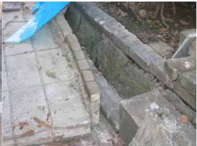
C ブロック塀 鉄筋有であるが基礎が不十分
