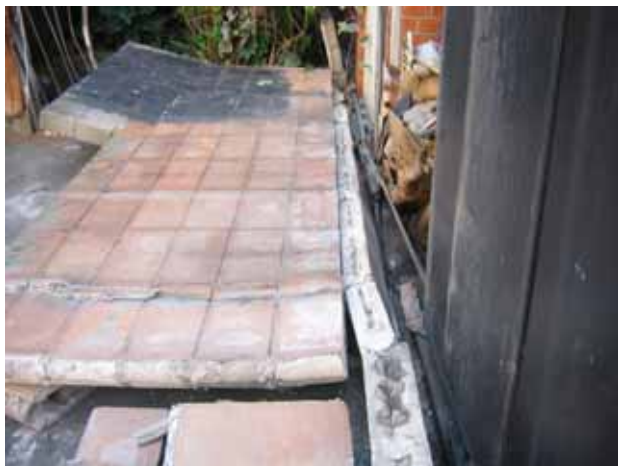
F ブロック塀 鉄筋無
