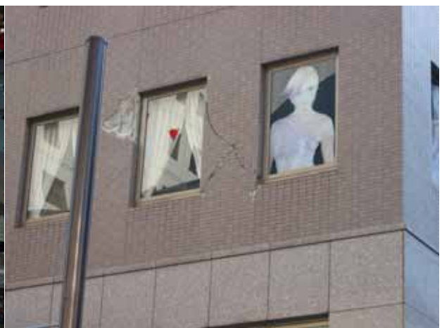
3 外壁損傷（方立て壁・二次壁？）
