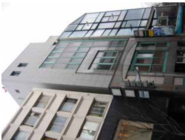
5 鉄骨造建物 外壁剥落
