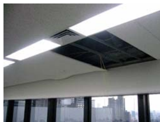
天井の落下:28階
