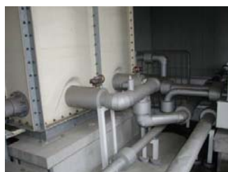
設備・ライフライン機器
