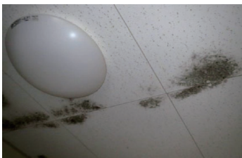
写真4 天井でのカビの発生状況
