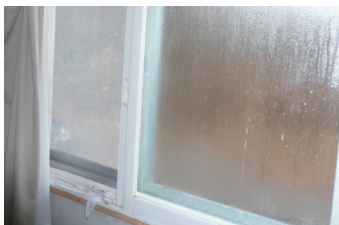
写真5 窓での結露の発生状況
