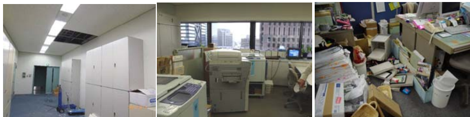
14F (天井パネルの落下)
