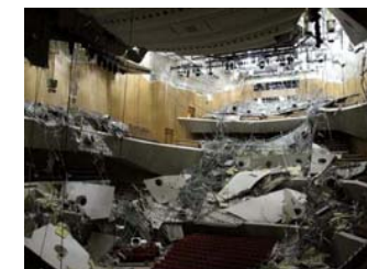
天井落下(川崎市音楽ホール)
