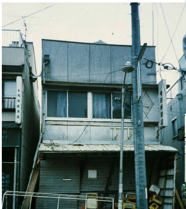
古い木造住宅の破壊 (特に1階部分)
