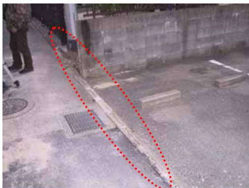
写真7 ブロック塀倒壊箇所
