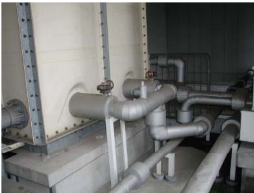
設備・ライフライン機器
