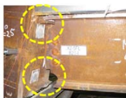
梁端フランジの破断
