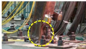
1階柱脚の局部座屈(四角い柱がへこんでいる)
