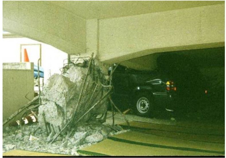
図7 旧基準の RC 造建物のピロティ階の被害
