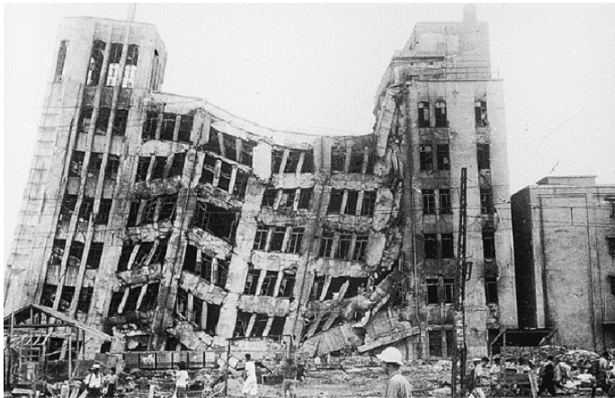
損壊した大和百貨店（福井市）。1階が潰れ、各階の梁が著しく破壊し、また火災による被害も受けた。小林啓美氏（東京工業大学名誉教授）撮影・提供。
