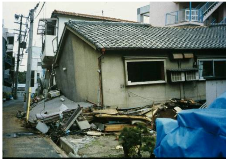
図5 1階の壁不足による木造家屋の被害
