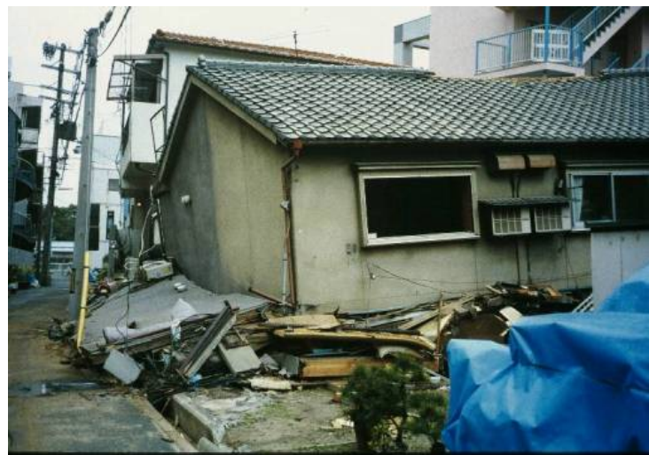
図5 1階の壁不足による木造家屋の被害
