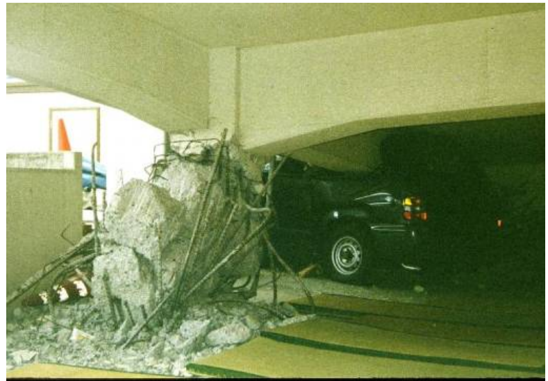
図 8 新耐震基準の RC 造建物のピロティー層の被害
