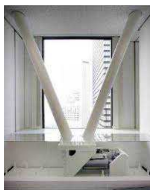
新宿センタービル(制振ダンパー)
