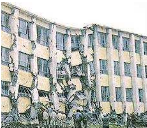
1968年十勝沖地震 (RC造短柱被害など)
