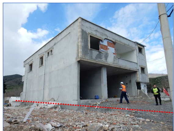
2階建RC造: 基礎・壁の高い剛性で小変形(半壊)
