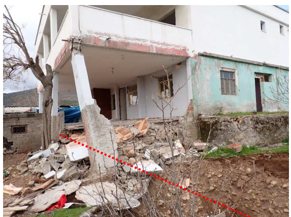
2階建RC造: 1階躯体の変形(全壊)
