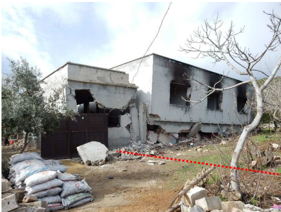
2階建RC造: 1階倒壊・火災発生
