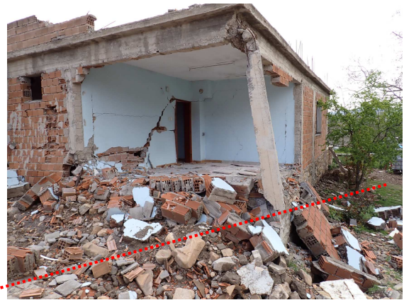
平屋RC造: 大きく変形(全壊)
