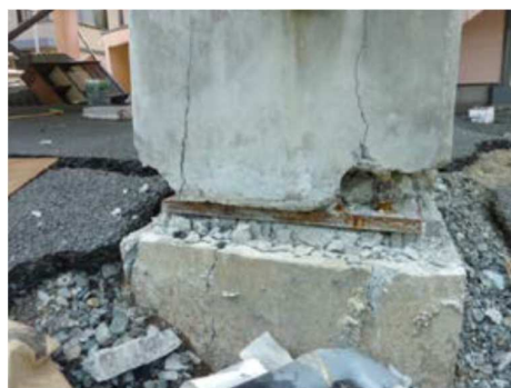
柱脚部の破損
