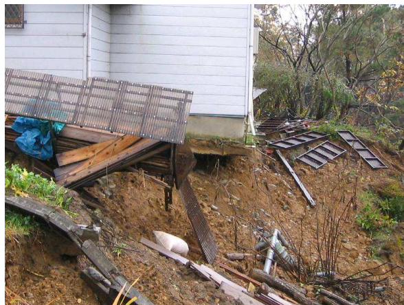
盛土地盤の崩壊(2003年新潟県中越地震)
