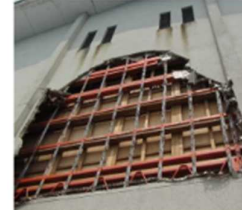
避難所の被害(熊本地震) (国土交通省、2016)
