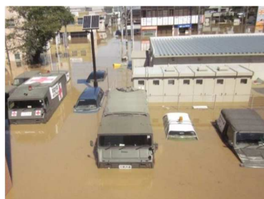
2015年関東・東北豪雨時の 常総市庁舎の電気設備被害
