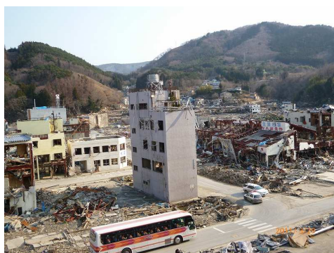
2011東日本大震災の津波に耐えた女川 町のRC建物(久田, AIJ大会-PD 2019)
