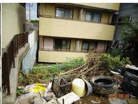
半地下のマンション (浸水被害)
